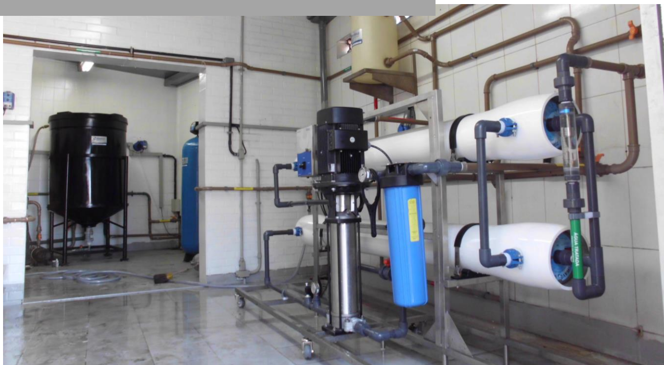
OSMOSE REVERSA LINHA MAX INSTALADA NO RIO DE JANEIRO
