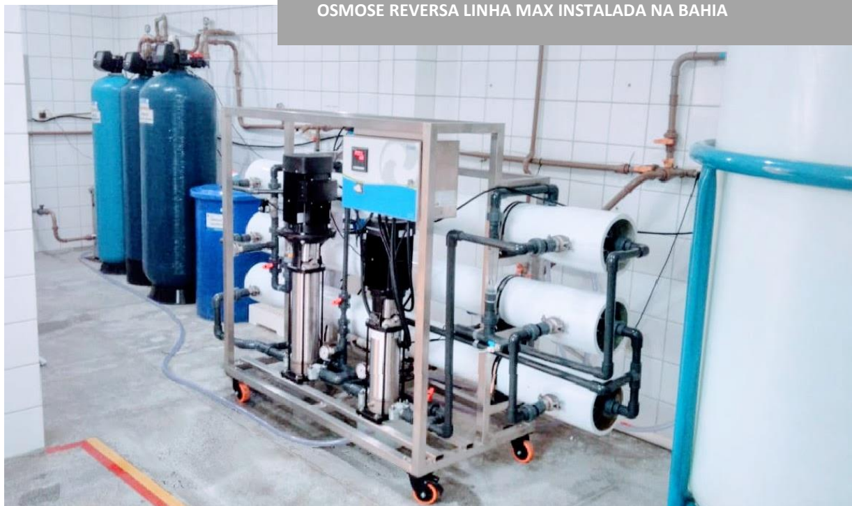
OSMOSE REVERSA LINHA MAX INSTALADA NA BAHIA
